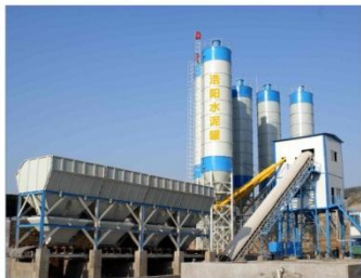
混凝土配料系统
